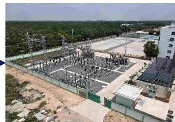
Trạm (110/22kV) tại KCN
