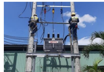
Trạm hạ áp (22/0,4kV)
